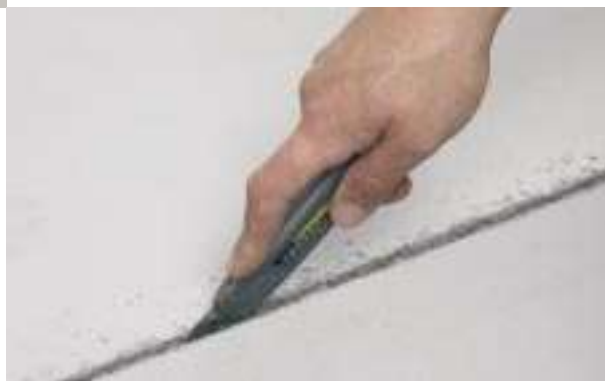
...złamać płytę (nad krawędzią)...
